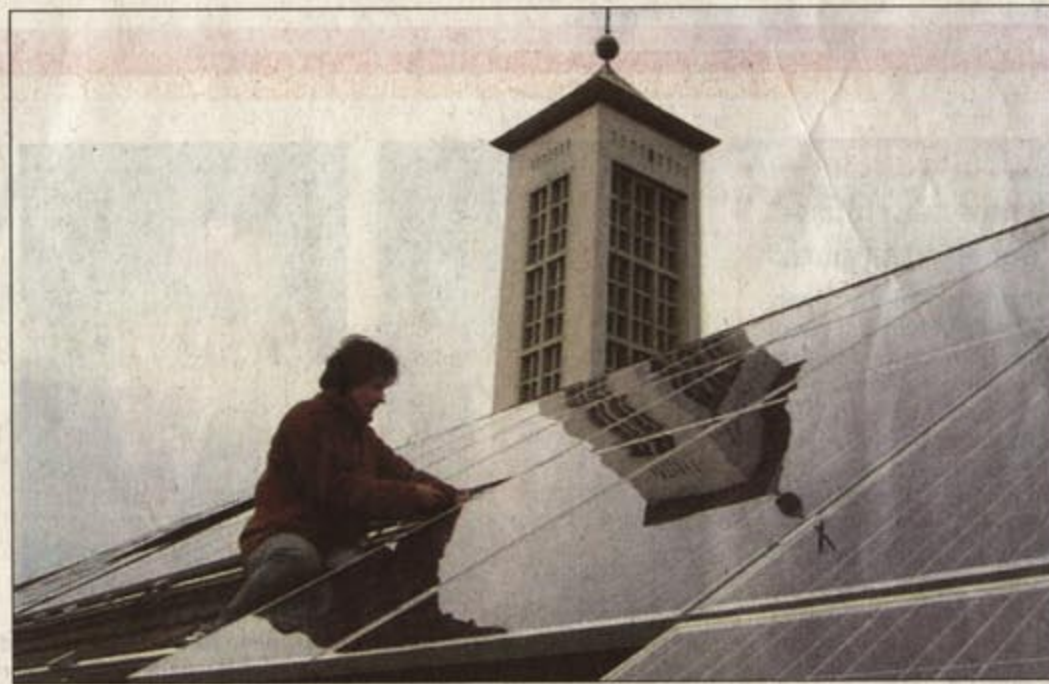
Wenn die Anlage in der kommenden Woche von den Stadtwerken abgenommen worden ist, wird der Strom eingespeist. Alle Module sind am Wochenende installiert worden. Foto: Privat
